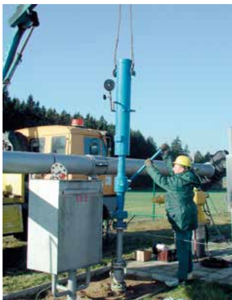
Obr. 4. Zásobník vakua střední velikosti při odsávání olejové jímky
